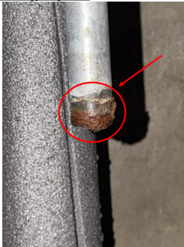
Фото 2. Поврежденный резьбовой участок отвода ХВС. Выраженные продукты коррозии в зоне разрушения.
