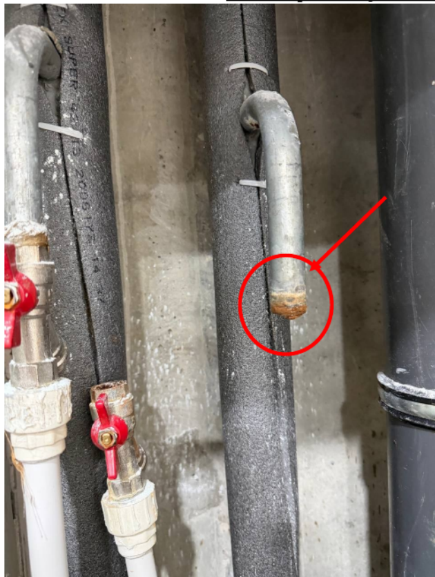
Фото 1. Общий вид отвода стояка ХВС. Красным обозначено место повреждения до первого запорного устройства.
